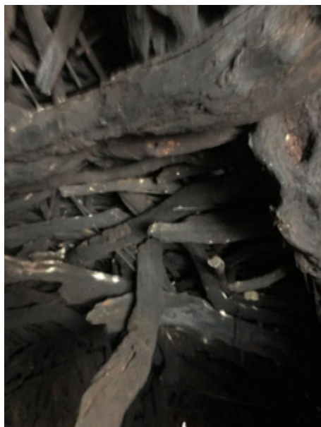
Figure 61. Part of the roof structure charred by smoke from a fireplace [Део кровне конструкције препариран димом са огњишта]
