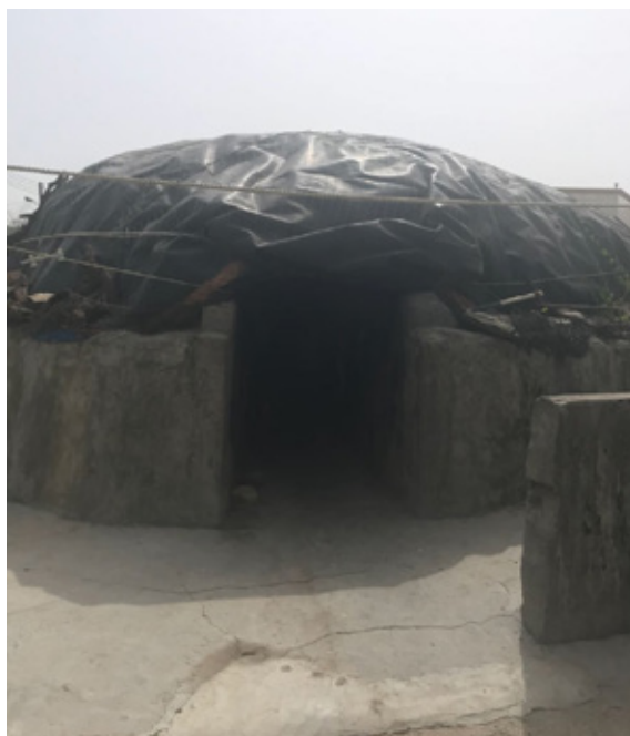
Figure 40. Entrance to the house. Thick foil tied with ropes has recently been placed over the roof to protect it from precipitation. [Улаз у кућу. Преко крова је недавно стављена дебела фолија увезана са конопцима ради заштите од падавина]
